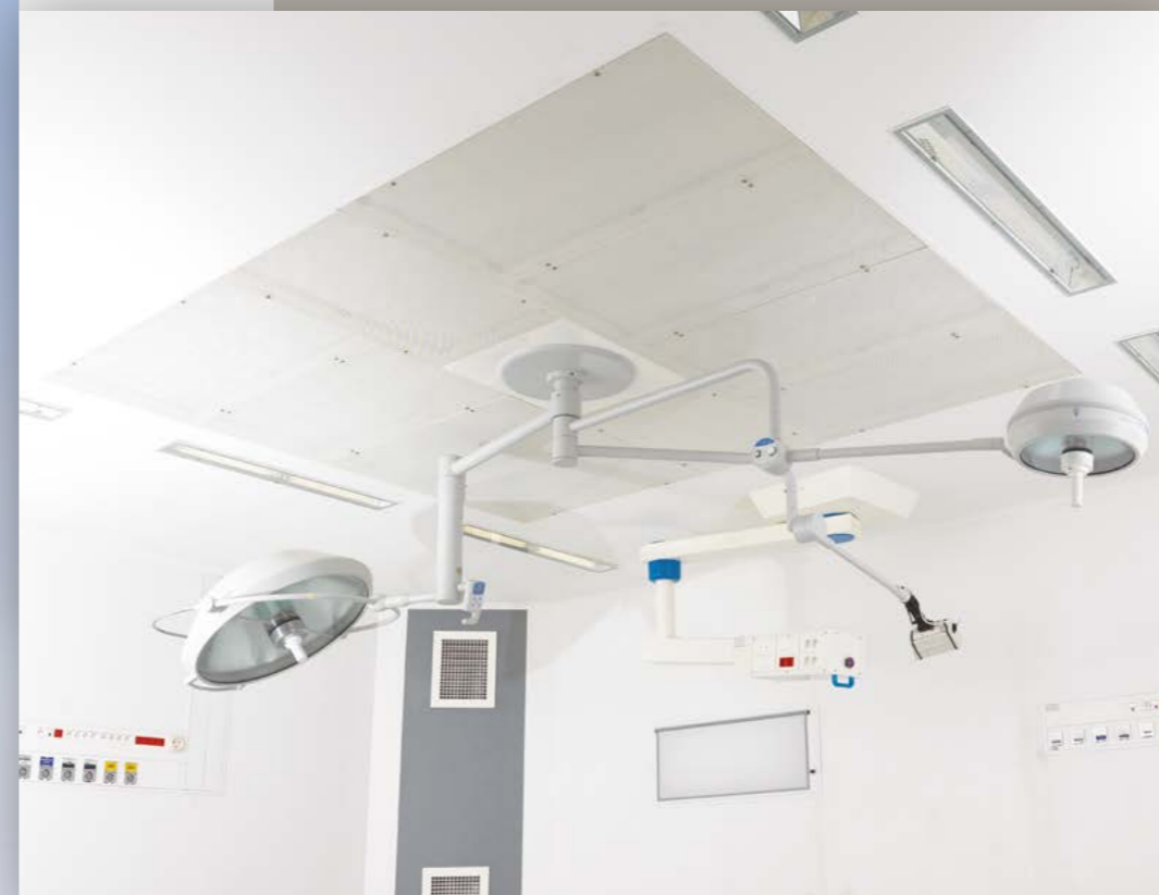
BVX3 installé dans une chambre individuelle BVX3 installed in an individual room
